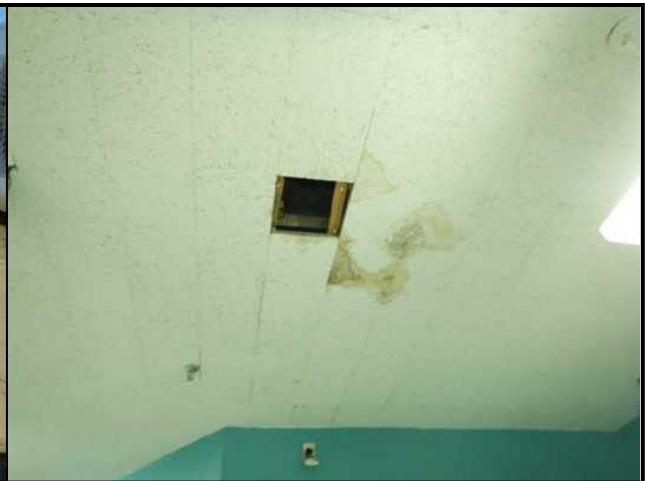
4 th floor tenant space roof leak
