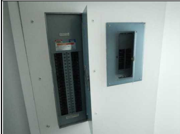
Tenant circuit breaker panels
